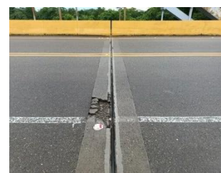
Daño en el bloque de transición por degradación del material
