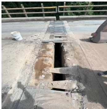
Estado inicial de la junta a reparar
