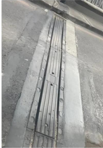
Comportamiento 3 meses después de la instalación
