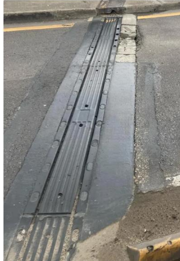
Comportamiento 1 año después con daños en bloque de concreto
