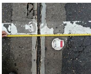
Daño en bloque de concreto y pavimento adyacente
