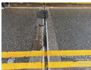
Daño en bloque de concreto y pérdida de sello
